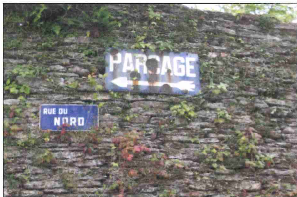
État du vieux mur avant restauration
